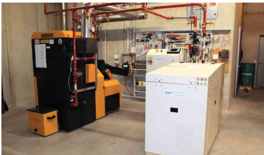
Die Jenni Energietechnik AG will die BHKW-Technologie bekannter machen. Auf dem Firmenrundgang wird deshalb immer auch dieser Technikraum im UG des neuen Produktionsgebäudes gezeigt. Links: KWB-Pelletsheizung, Typ KWB USV Z1, Leistung 60 kW. Rechts: Tedom T30, BHKW von BES (BHKW Energie-Service AG, www.bes-ag.com ), Typ Micro T30AP, Betrieb mit Erdgas, Leistung elektrisch 30 kW e und thermisch 61 kW th .
