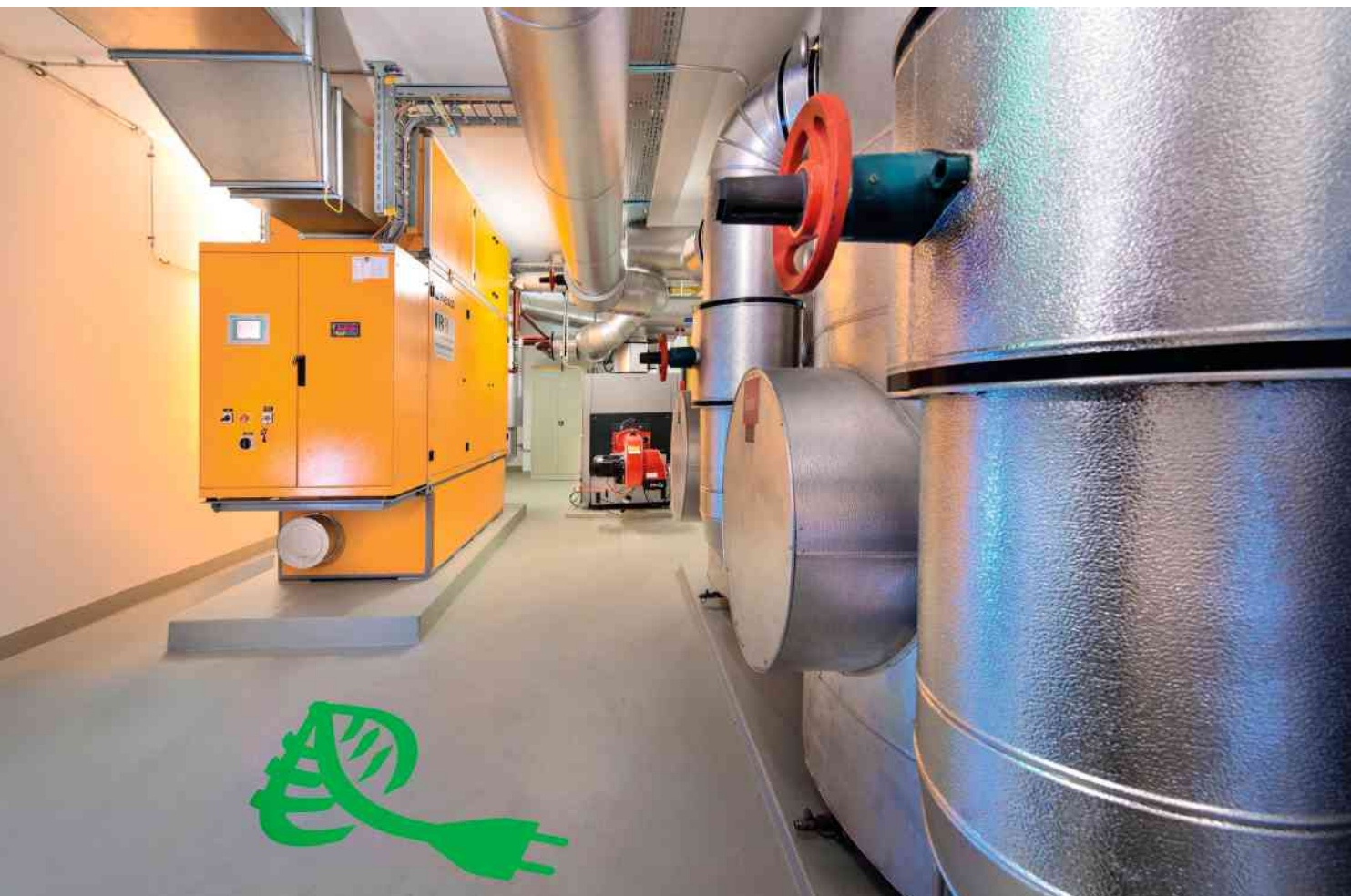
Wärmeverbund Schulanlagen «Hallwyler» in Brugg. (Referat Eugen Pfiffner)
