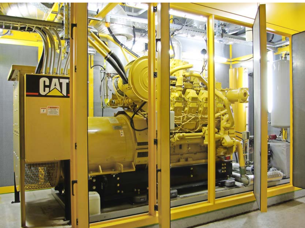
Gasmotor und Generator dienen bei WKK-Anlagen gemeinsam zur Wärme- und Stromerzeugung. (Bild: Avesco AG)
