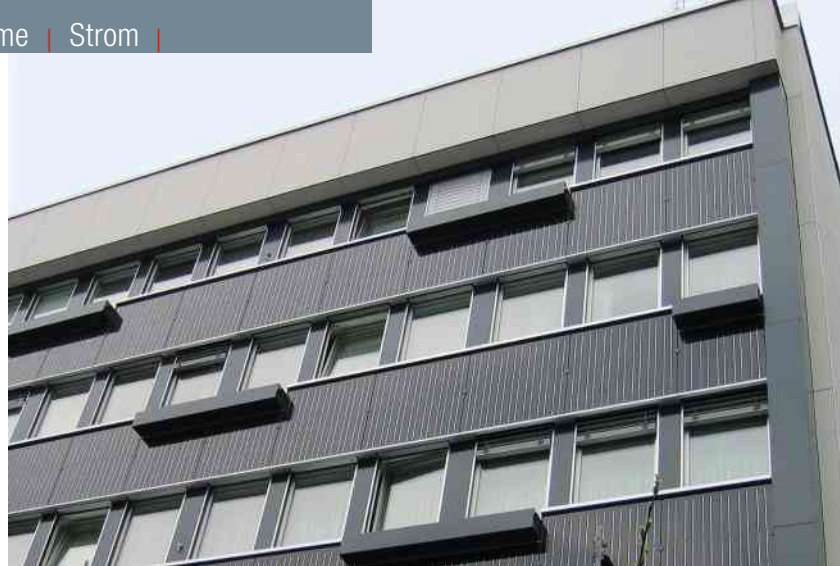
Substitution der Eternit-Fassade mit einer PV-Fassadenintegrationslösung im Bereich der Südfassade des Altersheims Werdgässchen in Zürich, 2005. (Foto: energiebüro ag)
