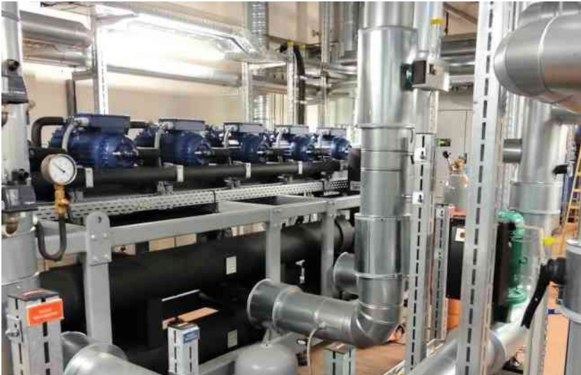
Im Technikraum des Wärmeversorgungsnetzes von Bergheim (D) arbeitet die Wärmepumpe mit 730 kW thermischer Leistung im direkten Verbund mit einem Blockheizkraftwerk. (Bild: Hafner-Muschler Kälte- und Klimatechnik GmbH)
