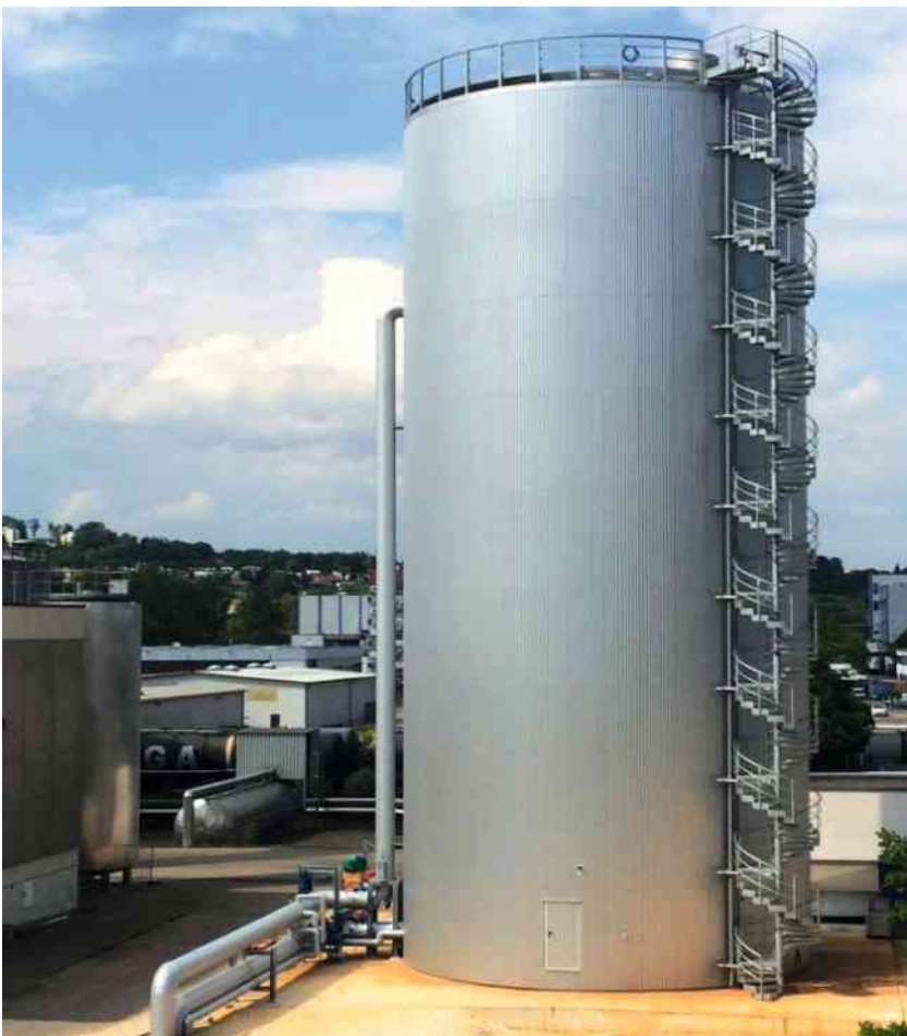
In Ulm (D) wurde im Jahr 2014 ein Druckspeicher mit einem Volumen von 2500 m 3 , einer Kapazität von 150 MWh und einer Temperaturspreizung von 150/70 °C erstellt. (Bild: Bilfinger VAM Anlagentechnik GmbH)
