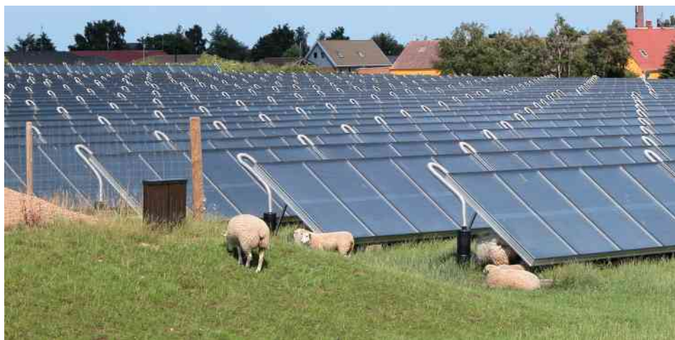
Grosse Solarwärme-Anlage in Dänemark. (Quelle: Erik Christensen, Marstral Dänemark)
