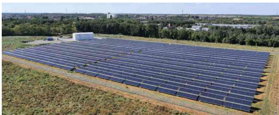
Solarwärme-Anlage für das Fernwärmenetz der Stadt Senftenberg. Diese ist mit 8300 m 2 die derzeit grösste solarthermische Anlage Deutschlands und die grösste Röhrenanlage der Welt. Sie ist seit August 2016 in Betrieb.
