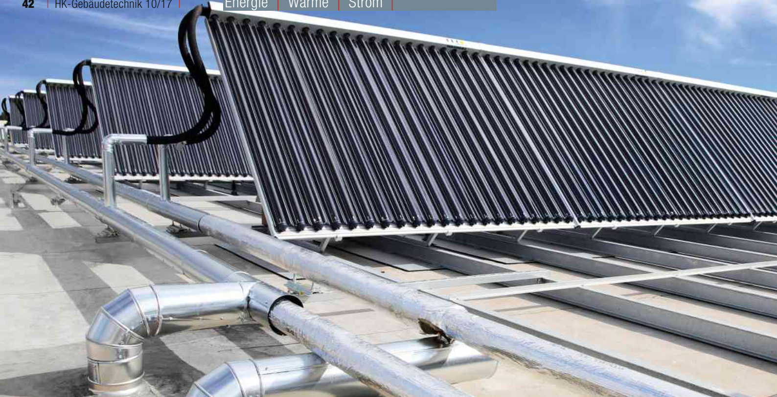
Beim Unternehmen Hustert Galvanik (D – Nordrhein-Westfalen) werden Teile für die Automobilindustrie galvanisch beschichtet. Über eine Ölkesselanlage werden die Tauschbecken beheizt. Seit Juli 2011 übernimmt dies teilweise eine thermische Solaranlage. (Bild: Ritter XL Solar).
