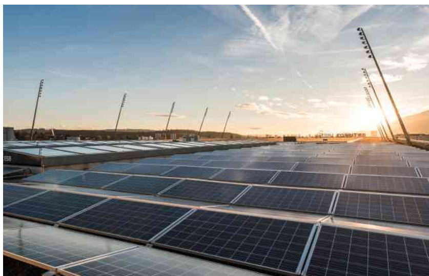
Die weltweit grösste, stadionintegrierte PV-Anlage auf einer Sport-Arena in Biel.
