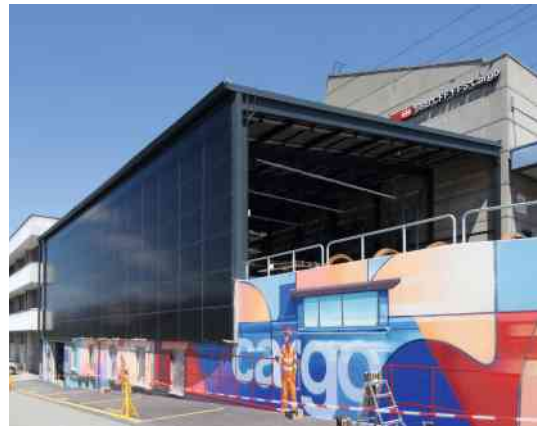
Beim Umbau der SBB Cargo-Halle in Muttenz wurde eine dach- und fassadenbündige Solaranlage integriert.
