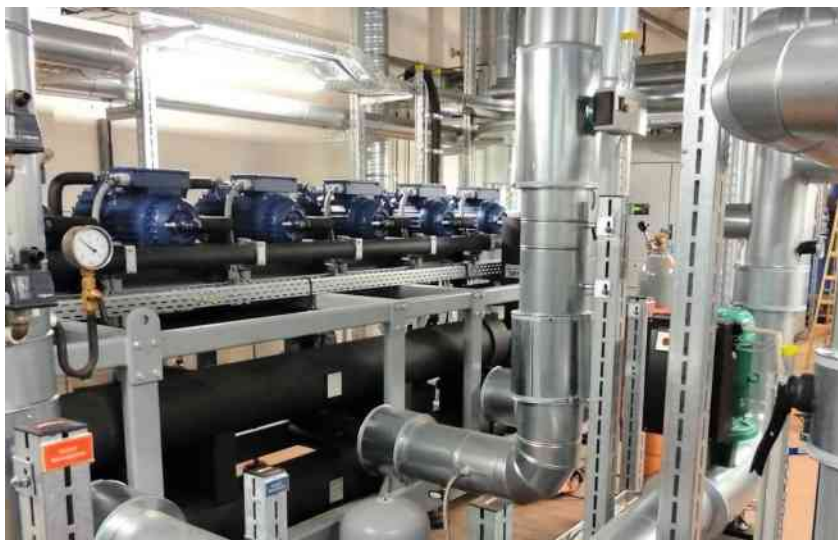
Im Technikraum des Wärmeversorgungsnetzes von Bergheim (D) arbeitet die Wärmepumpe mit 730 kW thermischer Leistung im direkten Verbund mit einem Blockheizkraftwerk. (Bild: Hafner-Muschler Kälte- und Klimatechnik GmbH)
