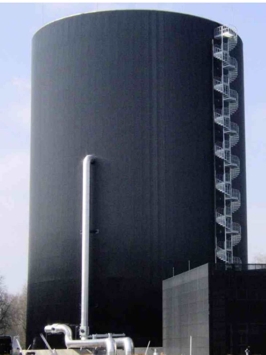
Im Jahr 2011 nahm die Fernwärme Salzburg Nord (A) einen drucklosen Speicher nach System Hedbäck mit einem Volumen von 29 000 m 3 und einer Wärmekapazität von 850 MWh in Betrieb. (Bild: Bilfinger VAM Anlagentechnik GmbH)
