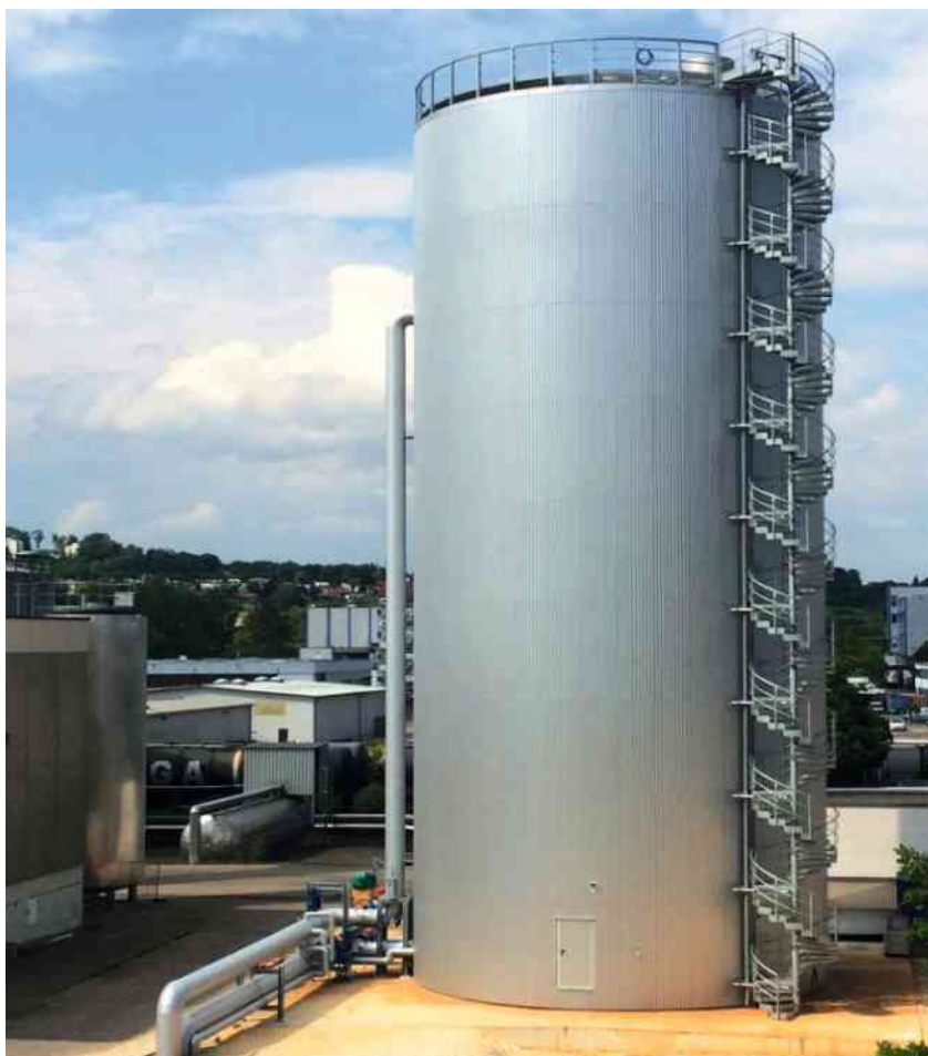
In Ulm (D) wurde im Jahr 2014 ein Druckspeicher mit einem Volumen von 2500 m 3 , einer Kapazität von 150 MWh und einer Temperaturspreizung von 150/70 °C erstellt. (Bild: Bilfinger VAM Anlagentechnik GmbH)
