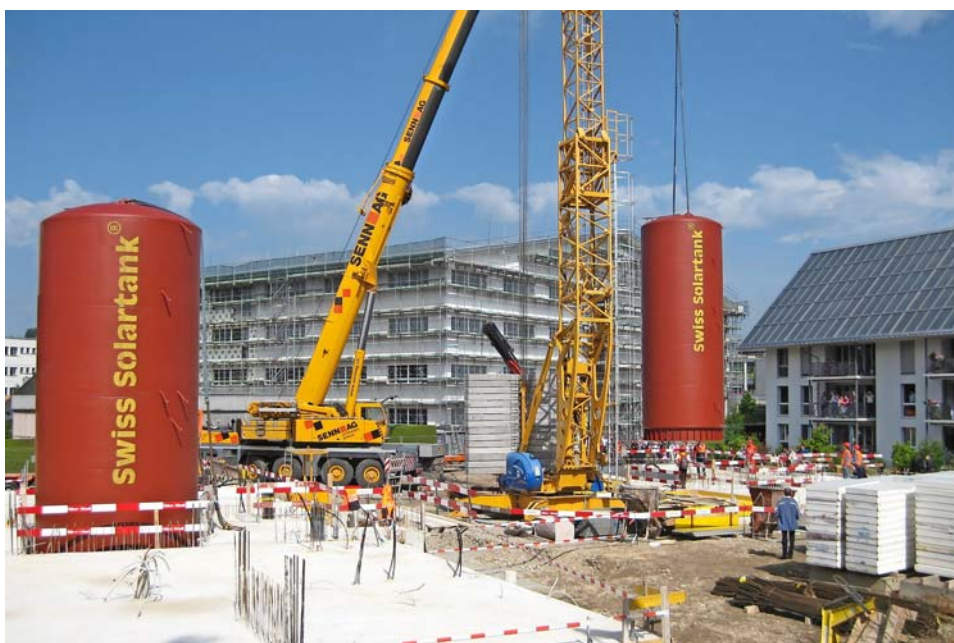
Hier wird der zweite Speicher versetzt. Rechts das bereits bestehende MFH. Hinten das neue Produktionsgebäude.
