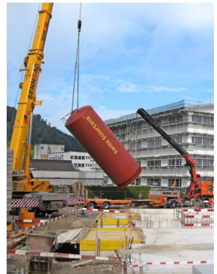
Die 108 m 3 -Speicher wurden liegend transportiert und dann mit zwei Pnekranen aufgestellt.
