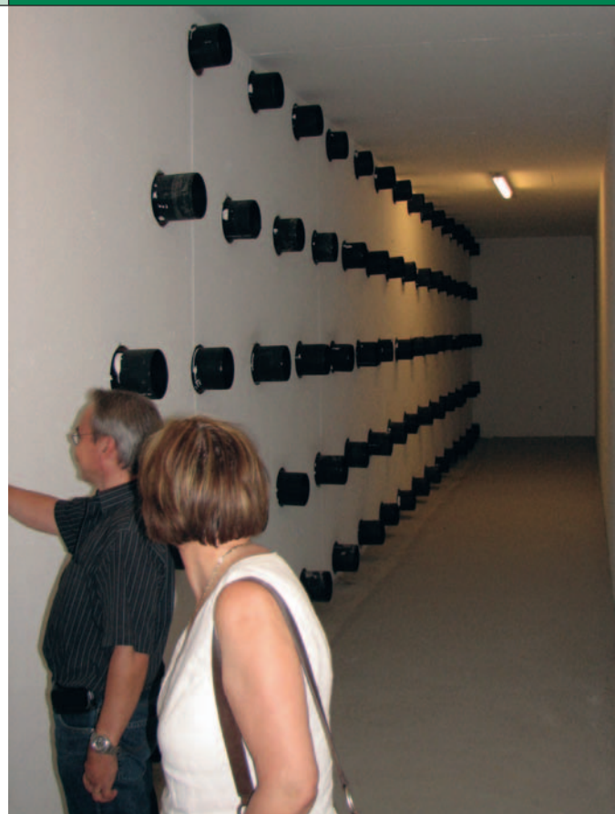
Blick in das grosse Erdregister: Lufterwärmung oder -abkühlung ohne Energiekosten.
