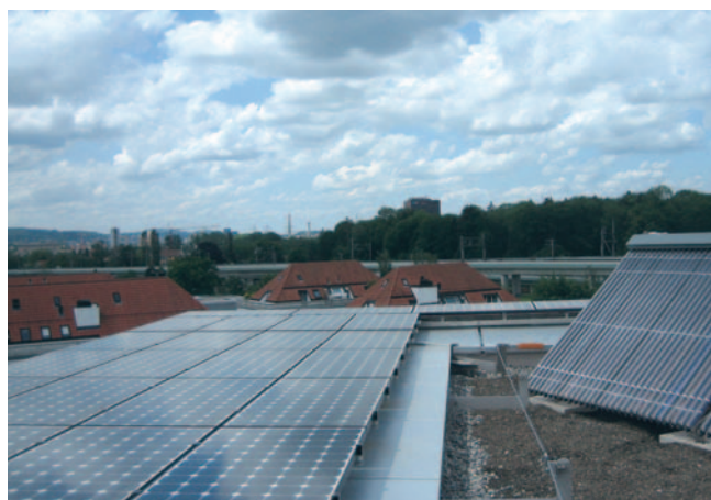
Nutzung der Solarenergie mit Photovoltaik und Solarkollektoren.
